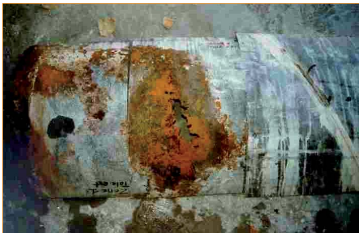
Figure 1 : Percement et défauts de corrosion sur une âme tôle.
